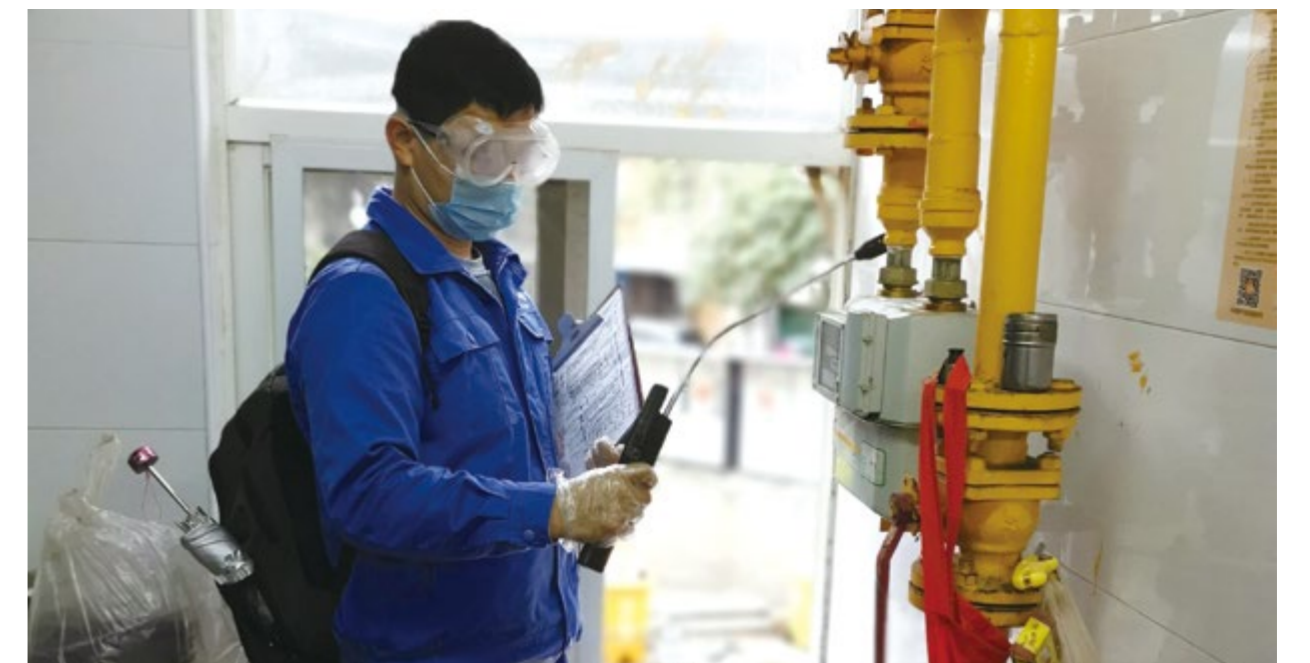
厦门公司对重点单位进行燃气安全检查
